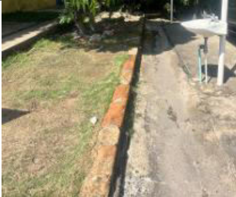
CA9. Desagüe de agua lluvia
